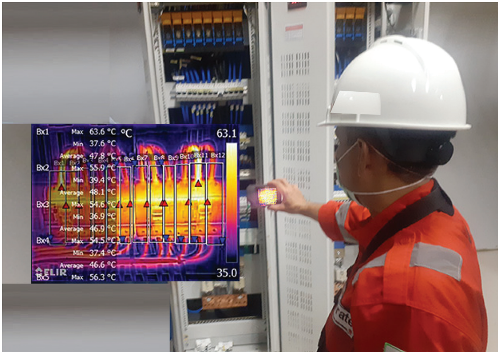
Gambar 4.1 Operator sedang Memeriksa Panel
