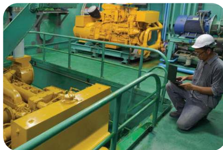
b) Perawatan Kamar Mesin
