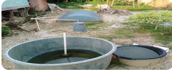
Gambar 1.9 Instalasi biogas dari serat kaca Sumber: Darmayanti (2022)
