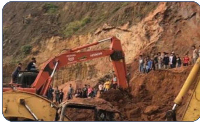
Gambar 8.4 Longsor yang terjadi di areal pertambangan tanah clay di Gunung Sariak, Padang.
