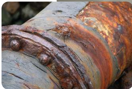
Gambar 11.12 Korosi menyebabkan kerusakan.
