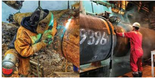
Gambar 2.5 Penggunaan teknologi las robot dan manual pada konstruksi pipa baja. Sumber: Steve M, 2022
