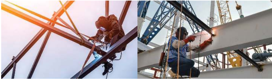
Gambar 4.22 Bekerja di ketinggian merupakan kondisi tidak aman dalam bekerja Sumber: Dekker, 2022
