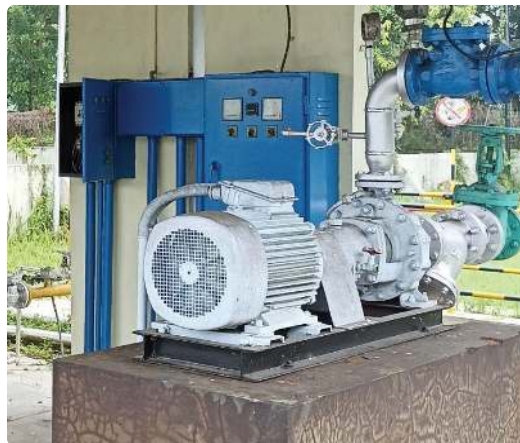
Gambar 7.31 Pompa Sumber: Siska (2023)
