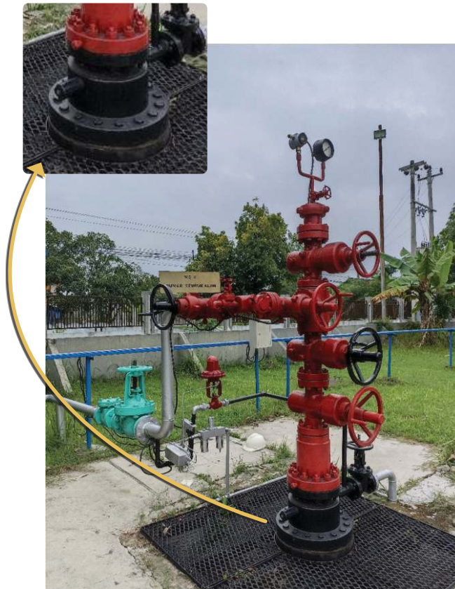
Gambar 7.21 Wellhead Sumber: Siska (2023)
