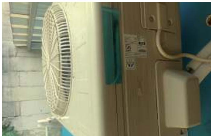
Gambar 8.15 Pendingin ruangan atau AC menggunakan freon
